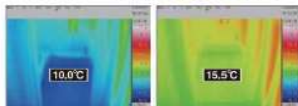
一般の断熱工法 アクアフォーム® *測定値は約、検証値ではありません
